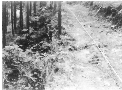
附図10 林内作業車道の盛土路肩部の状況
